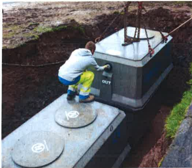
Une microstation a été installée pour l'immeuble propriété de la commune situé rue de la Mairie.
